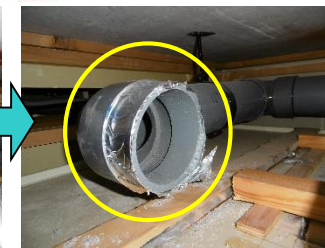
IV / 換気ダクト開口(浴室天井裏)
